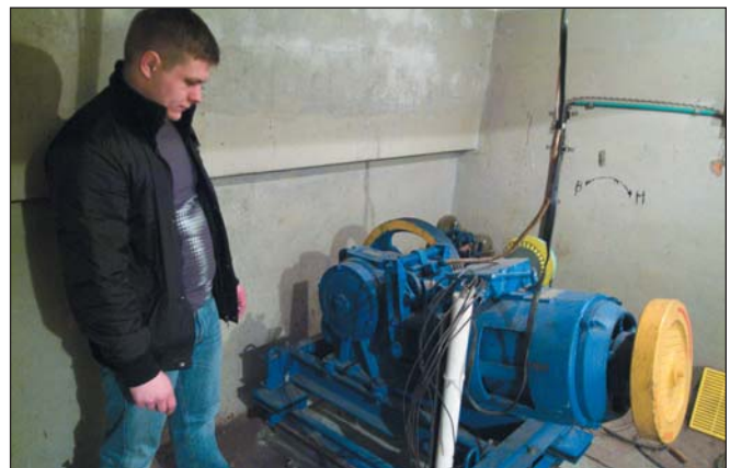
Прораб Владимир Варнавин рассматривает лебедку, где двигатель и редуктор установлены друг к другу под углом 15°
